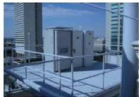
Aplicación en el techo de un edificio. PEM, Cabina de Hidrógeno y TPM.
