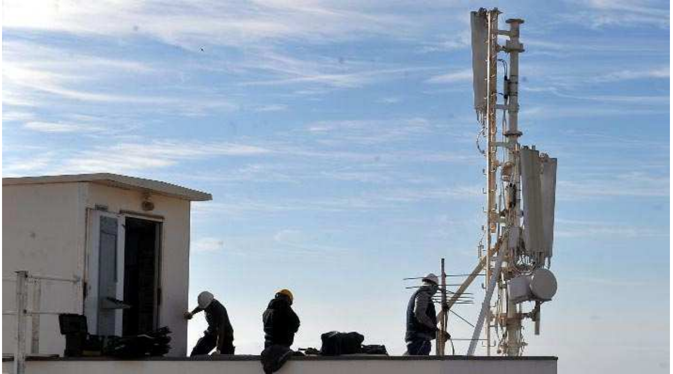
Figura – 1. – Antena de tecnología 4G ubicada en la terraza de un edificio en CABA. Fuente: Información provista por Telefónica Argentina, departamento de Energía.
