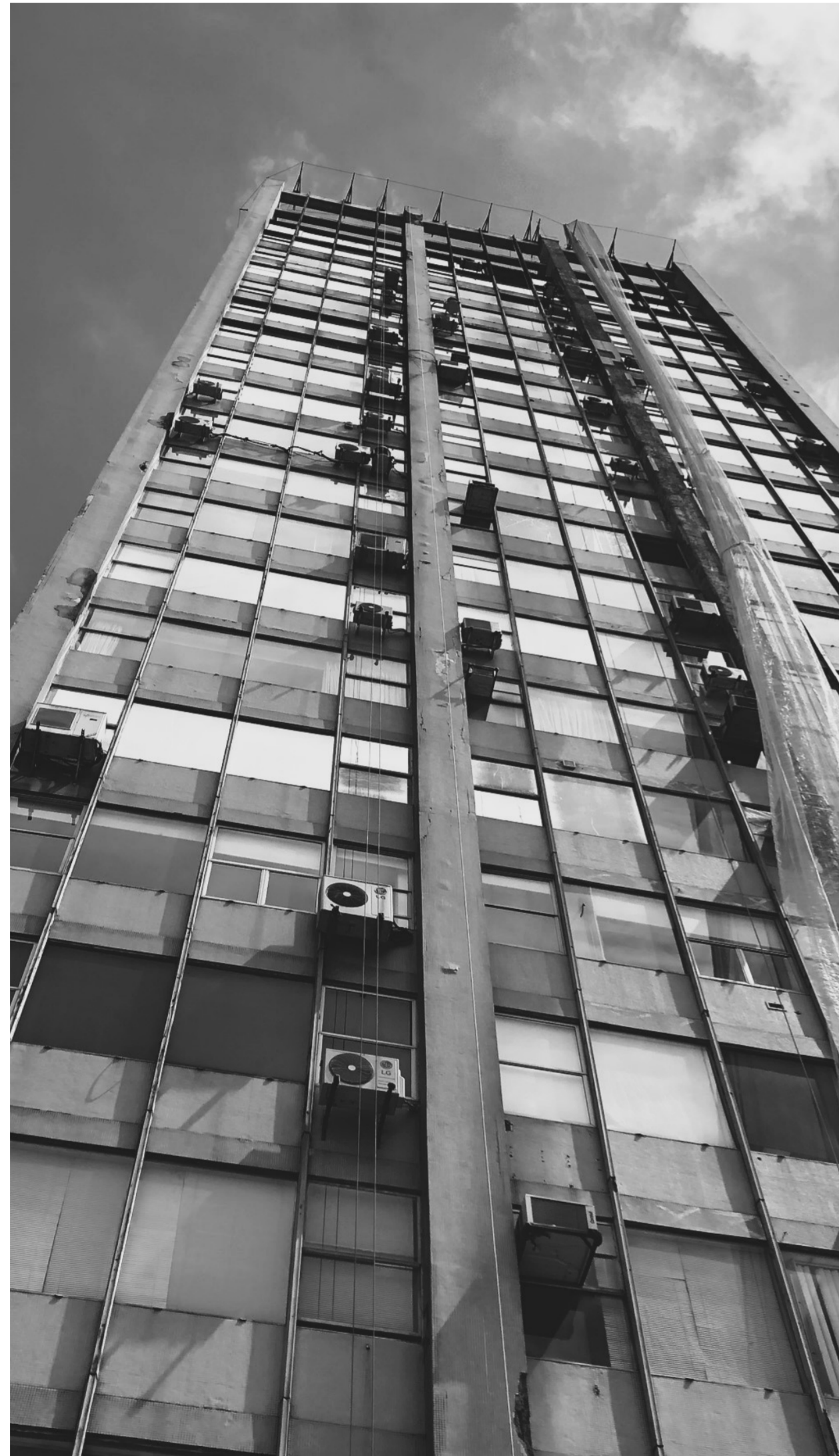
Galería Metrópole, San Pablo. Fachada en deterioro de la torre, vista desde el basamento. Fotografía propia, 2023.
