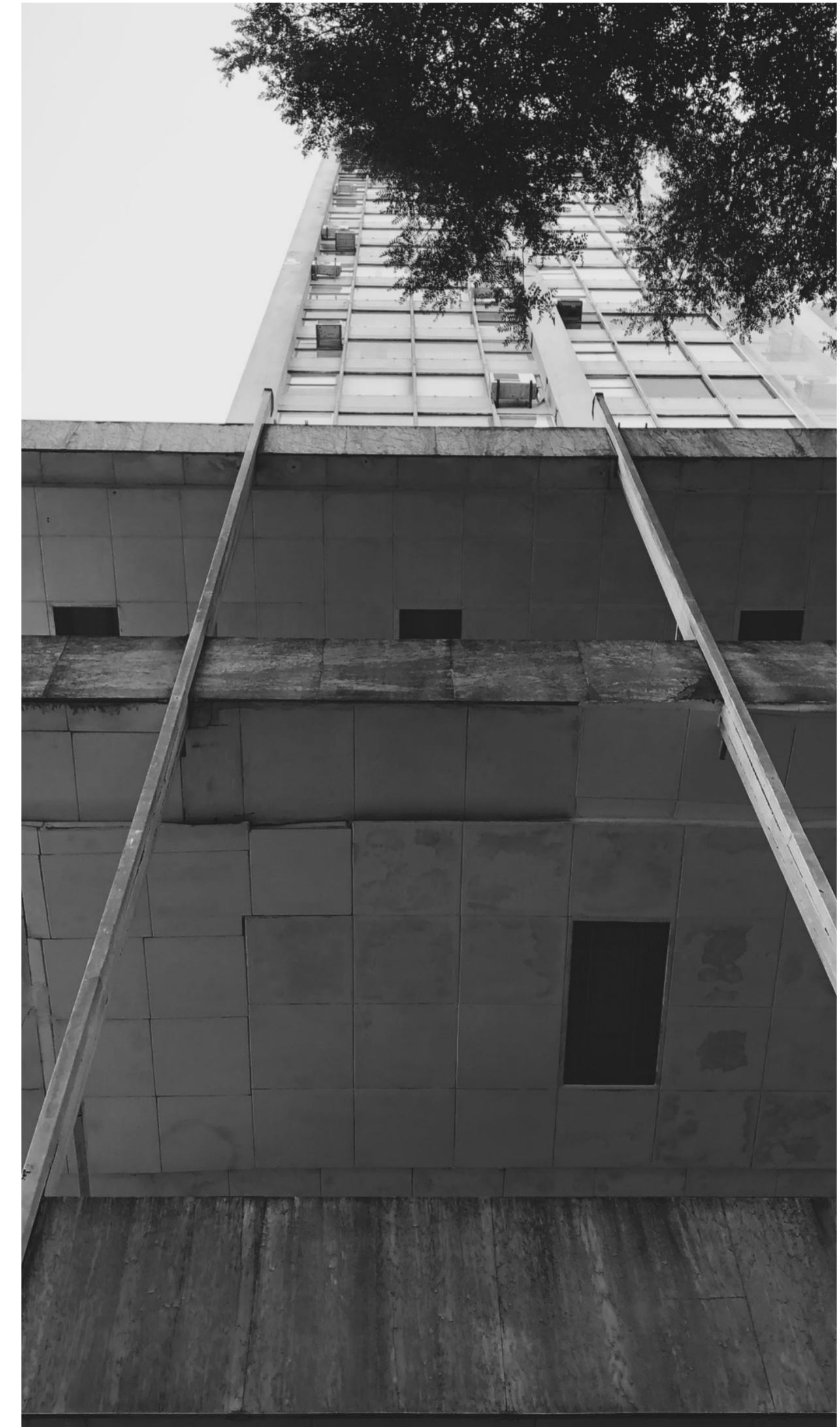
Galería Metrópole, San Pablo. Fachada y cielorraso del basamento en deterioro, vista desde plaza Dom José Gaspar. Fotografía propia, 2023.
