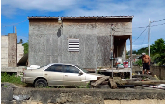
Aniceto comenzó el baño pero aún no lo concluyó. La vivienda muestra signos de deterioro y bajo nivel de habitabilidad. Foto: Autor (2022)
