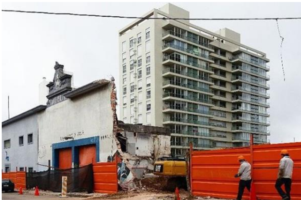
Fig.73 – Sustitución deseada: demolición de la antigua fábrica “La Buena Estrella” y la primera torre del complejo “Estrellas del Sur”.
