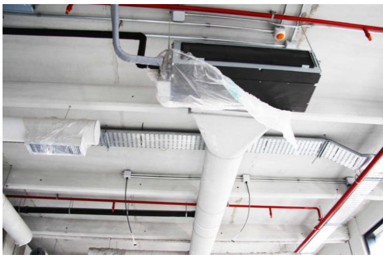
Imagen 21: Infraestructuras de base. Sede Dot. Fotografía: Violeta Amuchástegui. 2018
