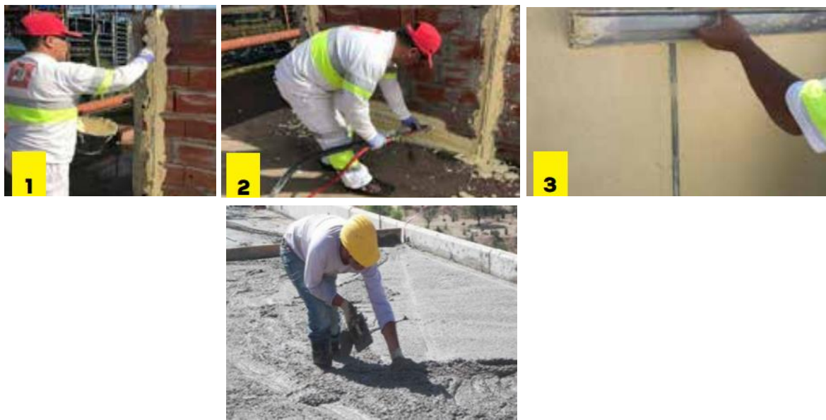
Figura 69. Proceso de colocación de revoque y contrapiso termoaislante. Fuente: Weber. Saint Gobain.
