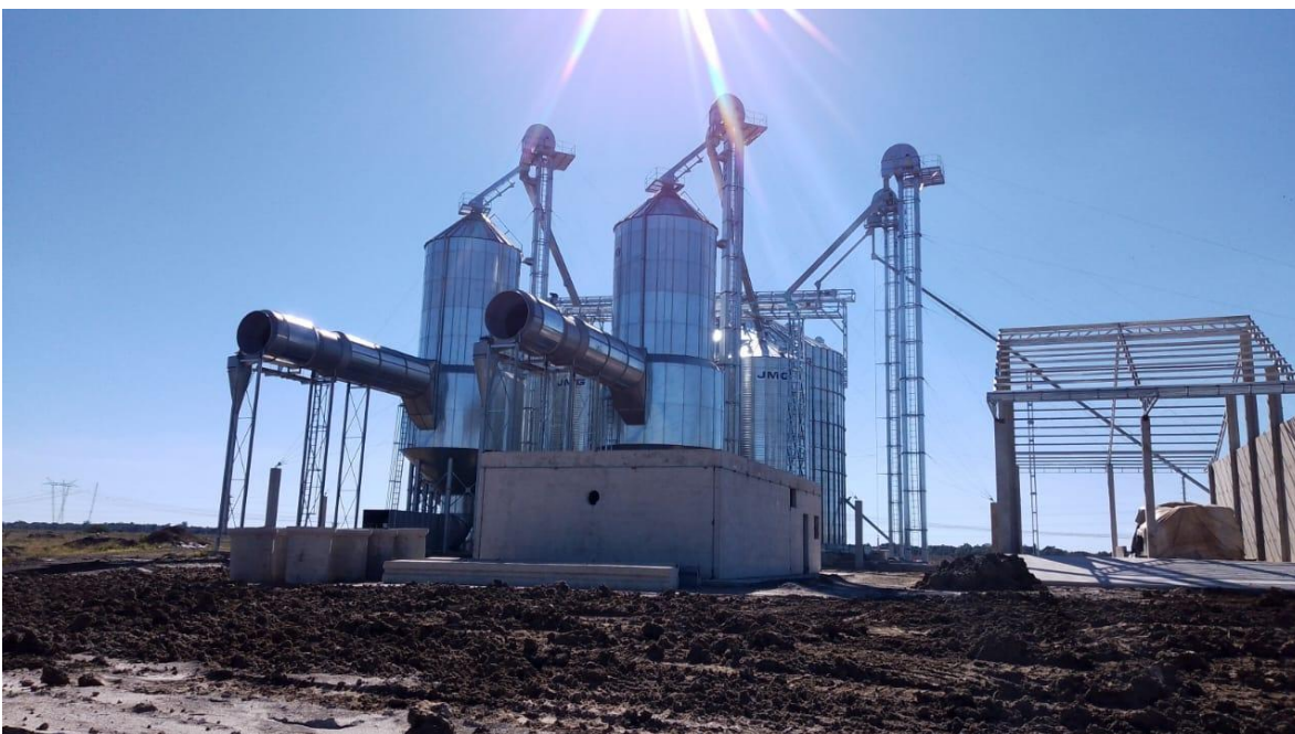
Imagen 6: Vista frontal planta de secado – quemadores, secadoras y silos de almacenamiento. 20
