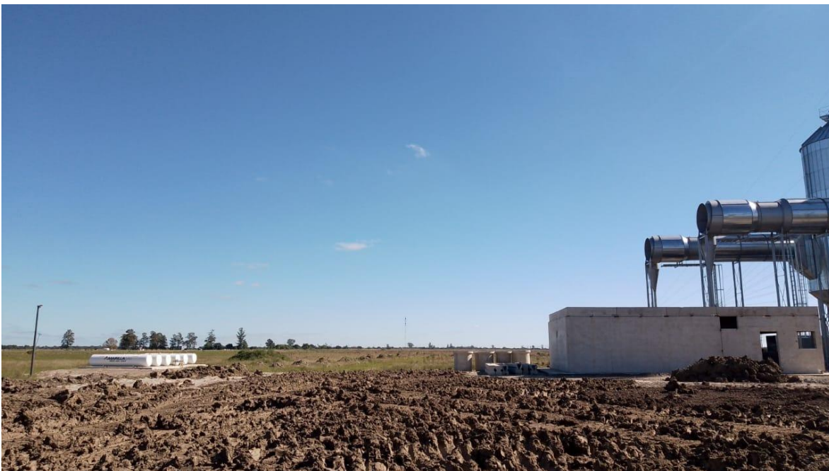
Imagen 5: Vista lateral planta de secado y tanques de almacenamiento de GLP. 19
