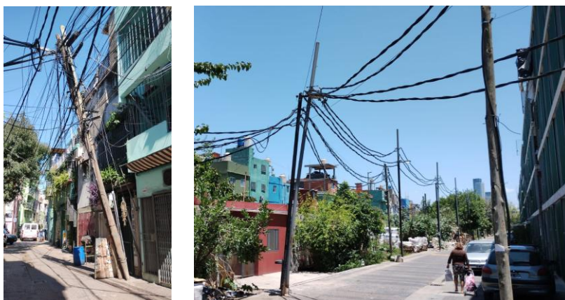
Imagen 35. Cables de red eléctrica en calles del Barrio Mugica.
