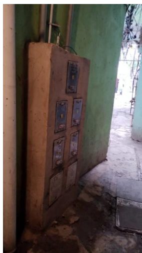
Imagen 36. Estructuras con medidores eléctricos en pasillo del sector 2 del BM.
