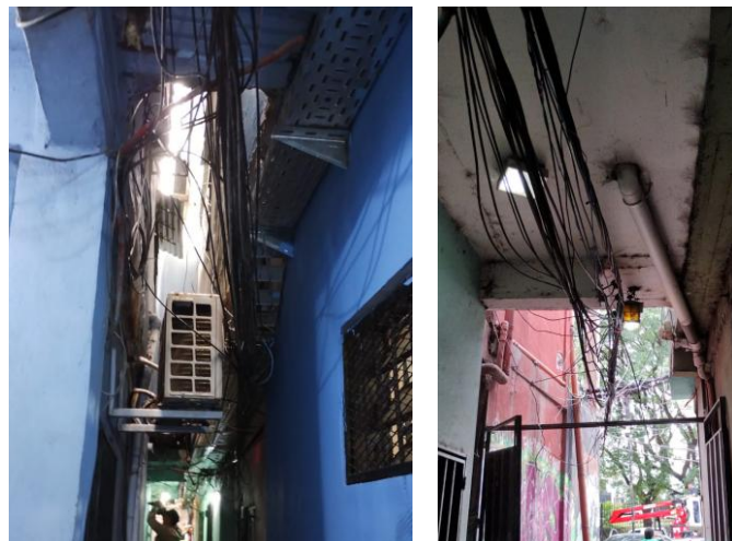
Imagen 37. Cableado eléctrico en el interior de un pasillo del sector 1.
