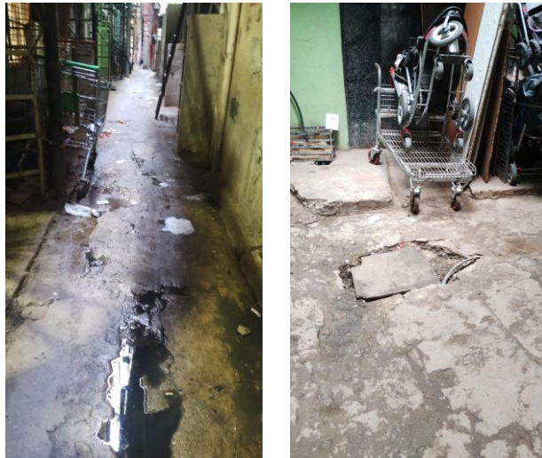
Imagen 40. Red de desagüe en pasillo del sector 1 del Barrio Mugica.
