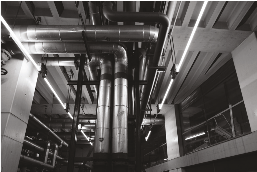
MRAYÁ. SOMISA. Sala de máquinas termomecánicas en 6to subsuelo. Foto SP
