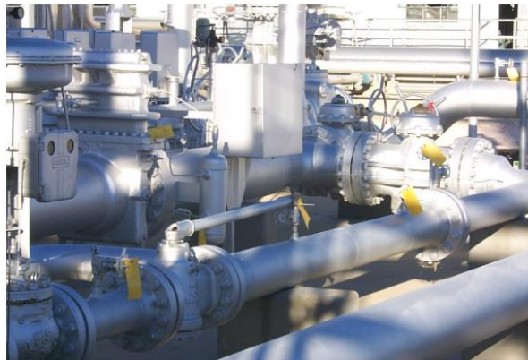
Figura 10 - Instalación de procesamiento de gas con etiquetas de fugas detectadas (Fuente: Global Methane Initiative, 2020)
