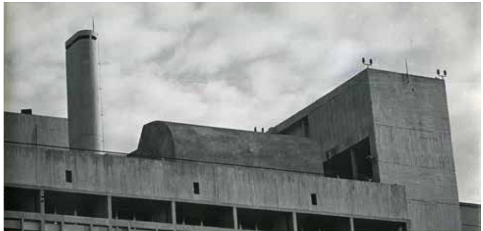
Imagen 28: Vista de la Cubierta del Instituto de Previsión Social de Posadas, Misiones
