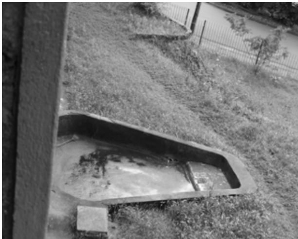
Detalles de la cisterna y receptáculo para desagüe pluvial de la escuela en Alem
