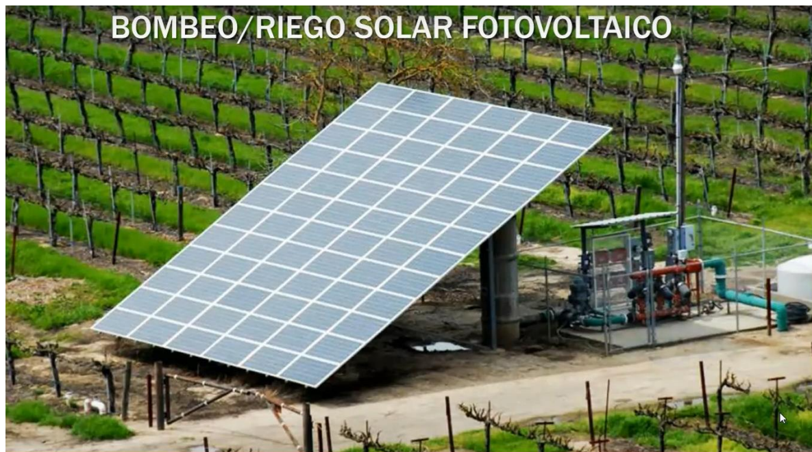
Figura 17. Ejemplo para grupo de bombas. Fuente: http://elementalenergy.cl/riego-fotovoltaico/
